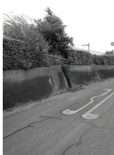
土手が割れた
