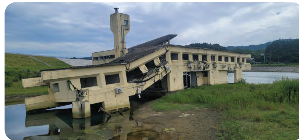
資料：筆者の撮影写真、津波で被害を受けた建物
