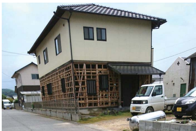
西日本豪雨による倉敷市真備町の被災状況（南撮影）
