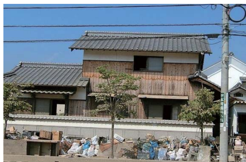
2階部分も浸水した建物 (外壁の痕跡で浸水深がわかる)
