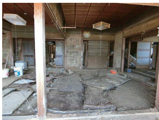
浸水した住宅の一階部分
