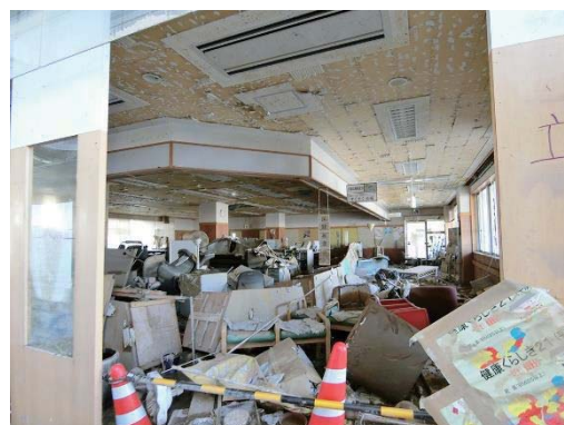
浸水した保健福祉会館の一階部分
